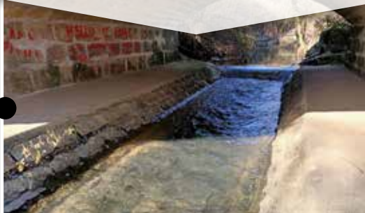
Modification du Pont Rue de Limpach & création d'une digue et d'un by-pass
