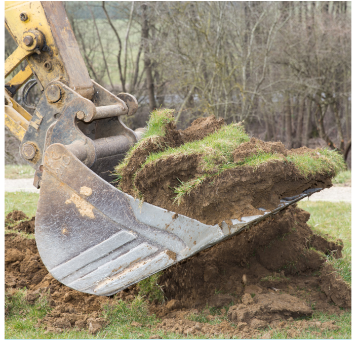
Mit der Erneuerung der „Bolzplatz“ in der rue Jean-Pierre Hilger konnte am 24. März begonnen werden
